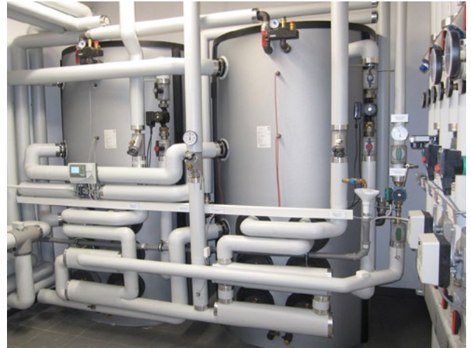
Abb.: Anlage mit 2x CAPITO 2-Zonen-Speicher 1500
